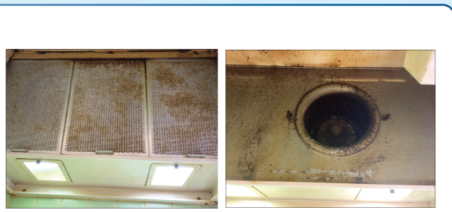
レンジフード内部ファン：油汚れ
