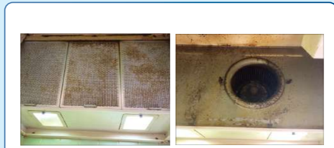
レンジフード内部ファン：油汚れ
