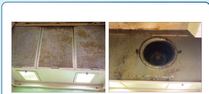
レンジフード内部ファン：油汚れ
