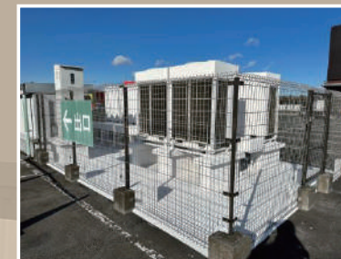
大型商業施設 (省エネ対策)
