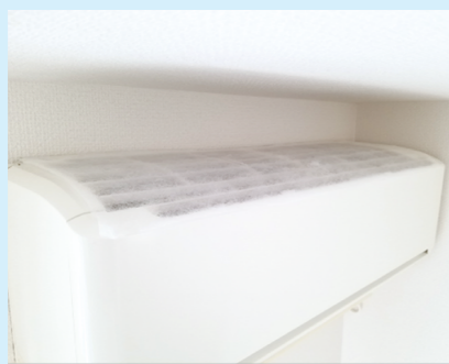
家庭用エアコン設置例)
